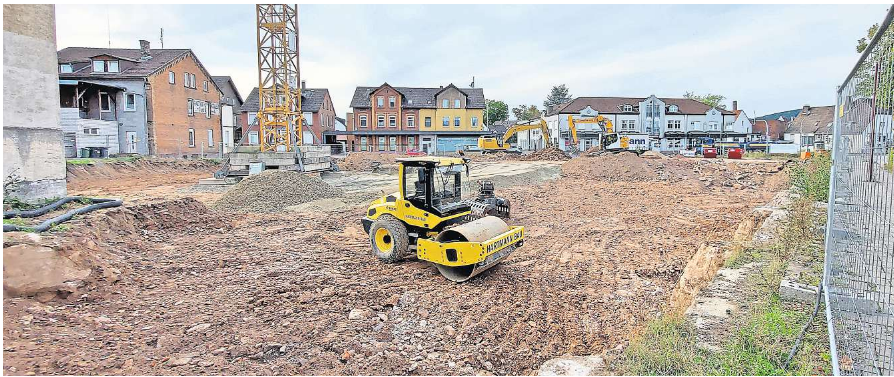
Auf dem ehemaligen Fricke-Grundstück zwischen Fürstenberger Straße und Bahnhofstraße wird jetzt gebaut. Es entstehen ein Pflegeheim und Seniorenwohnungen. FOTOS: SPE
