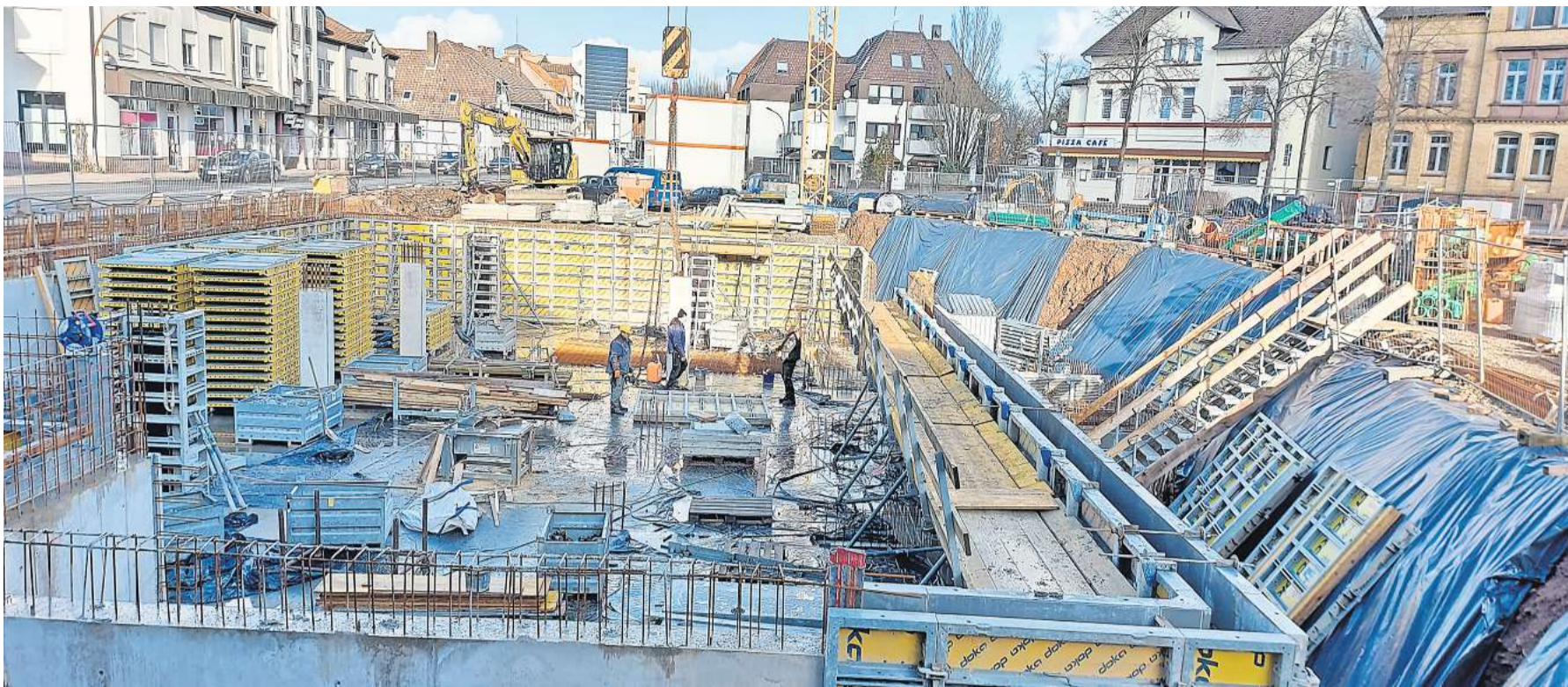
Blick in die bereits durchgeschaltete Baugrube an der Fürstenberger Straße: Hier entsteht eine Tiefgarage.
